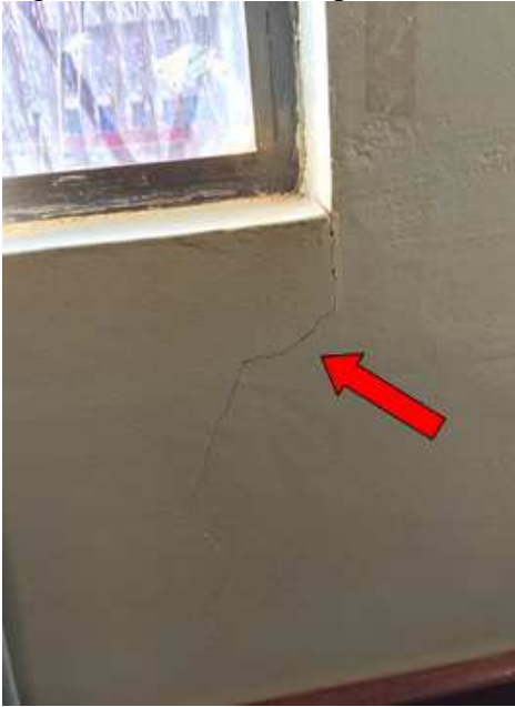
Figura 5 – Fissuras em paredes.
