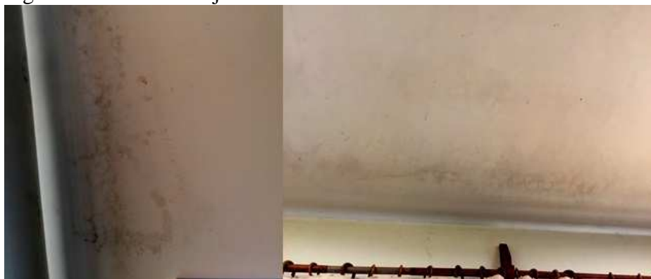
Figura 13 – Bolor na laje.
