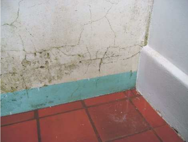
Figura 1 – Manchas escuras por respingos de chuva.
