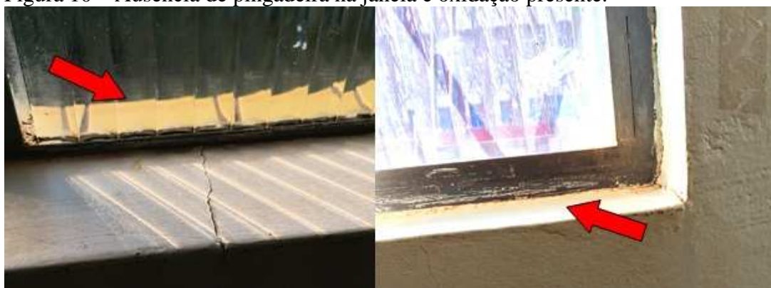
Figura 10 – Ausência de pingadeira na janela e oxidação presente.
