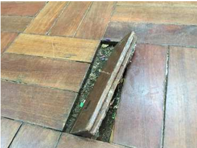
Figura 12 – Descolamento do piso em taco.
