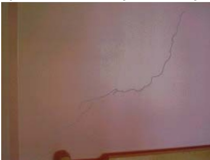
Figura 4 – Fissura inclinada em parede transversal por movimentação térmica da laje de cobertura.
