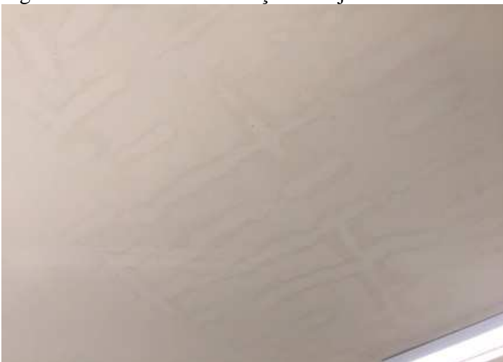
Figura 9 – Machas de infiltração na laje.
