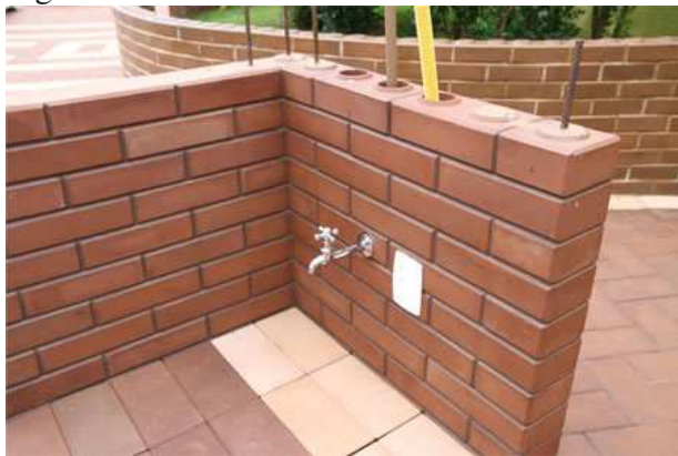
Figura 12 – Condutores elétricos e hidráulicos.
