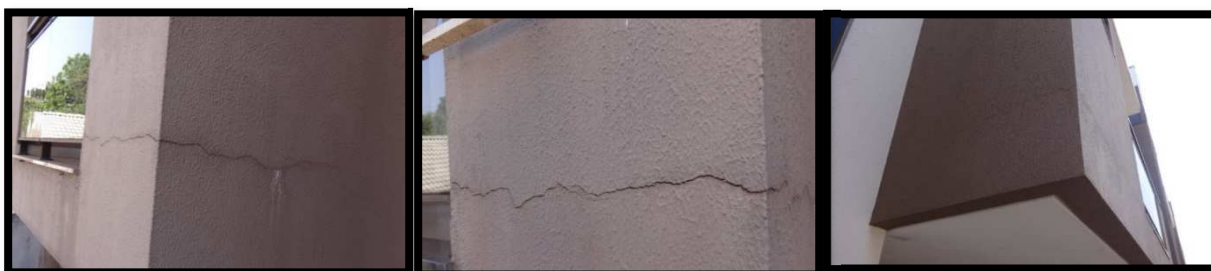
Figura 07, 08 e 09 - Fissuração e Trincas guarda corpo da sacada da suíte
