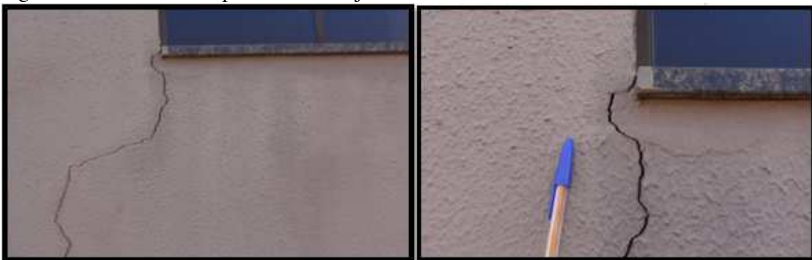
Figura 11e 12 - Trincas apresentadas na janela do BWC.
